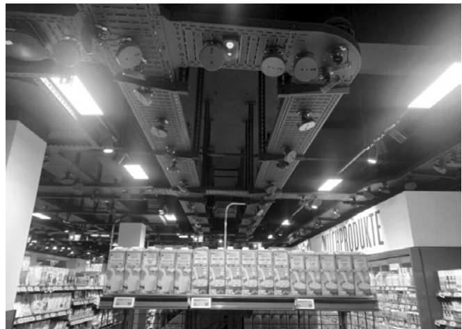
Hunderte dieser Kameras sind an der Decke entlang der Regalreihen installiert.
